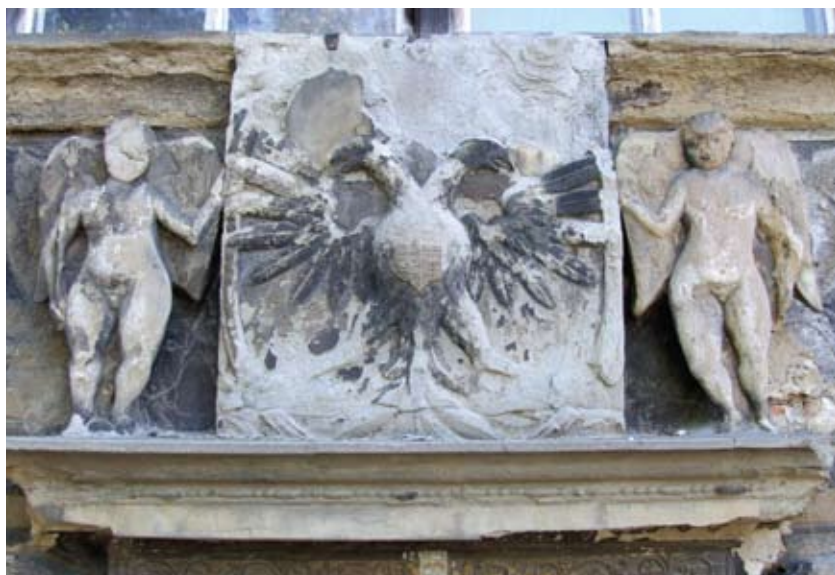
stav pred reštaurovaním / restaurálás előtt
