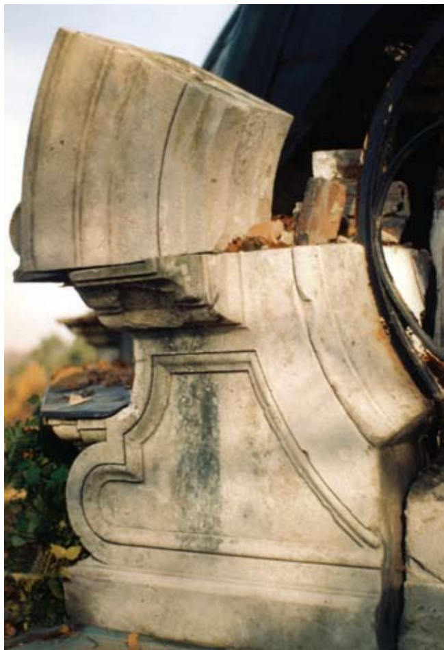
stav pred reštaurovaním/ restaurálás előtt
