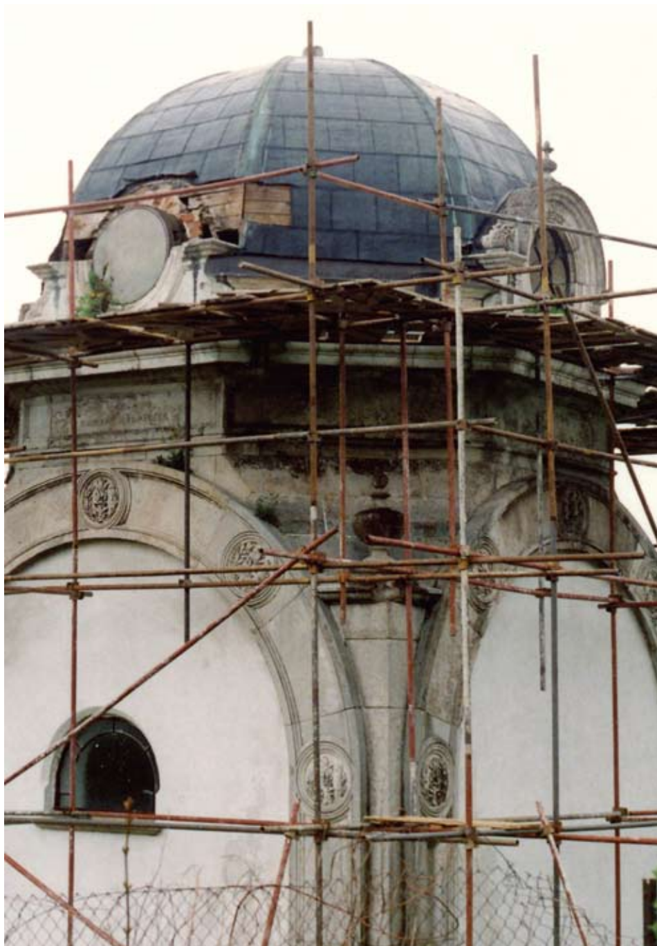
stav pred reštaurovaním/ restaurálás előtt
