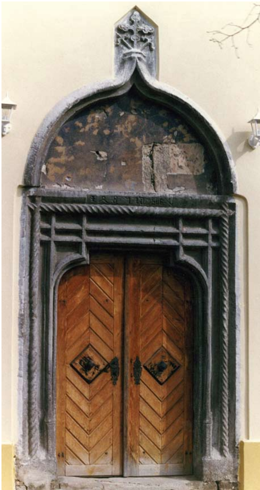
stav pred reštaurovaním / restaurálás előtt
