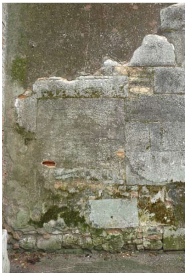
stav pred reštaurovaním / restaurálás előtt
